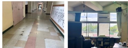
剥がれるがある廊下
